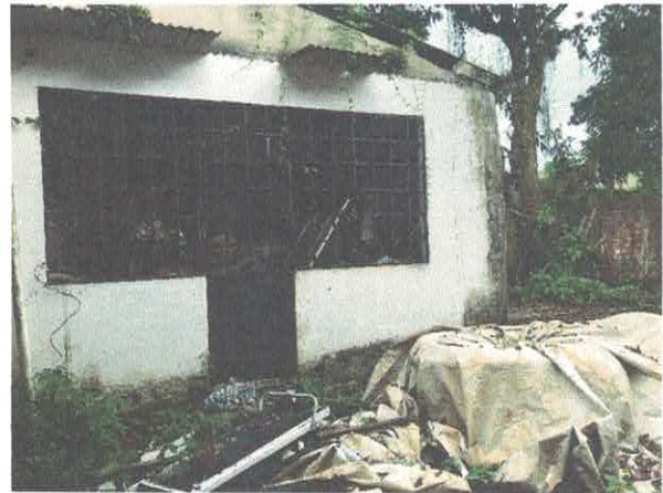
EDIFICAÇÃO 02 - INAPTA P/ USO
