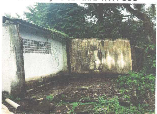
EDIFICAÇÃO 02 - INAPTA P/ USO
