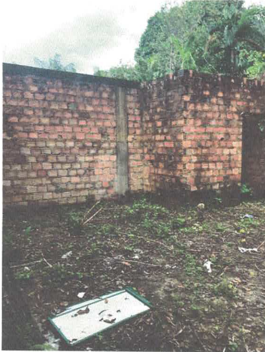
EDIFICAÇÃO 01 - INAPTA P/ USO
